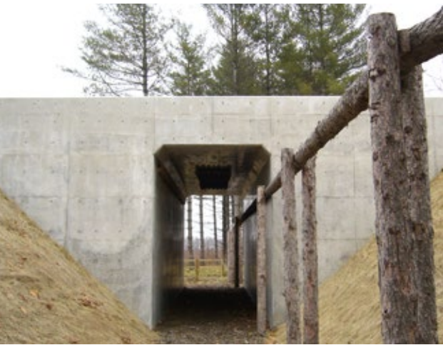
図6 樹上性動物（モモンガ、クロテン）の移動経路を備えたコウモリ用カルバート。
