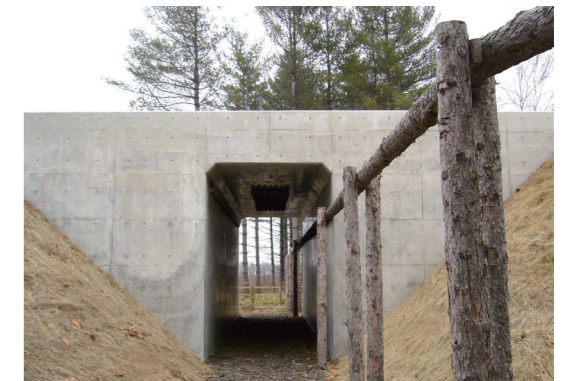
樹上性動物用通路も備えたカルバート
